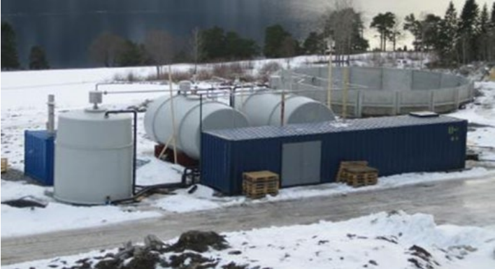
Anaerobic digester in Tingvoll
