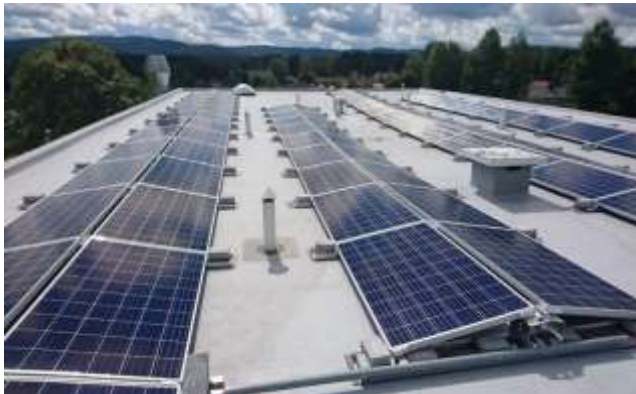
Solcellepanelene på tak, Aurskog sykehjem (foto: Ole-Christian Østreng)
