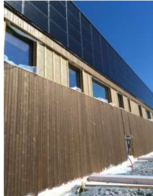
Solcellepanelene fasademontert sørvegg, ny Bjørkelangen skole (foto: Ole-Christian Østreng)
