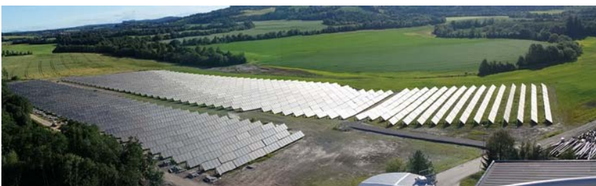
Bilde: Akershus EnergiPark, solfangeranlegget
